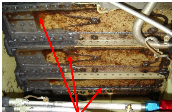
Crescimento microbiano em tanque de combustível
